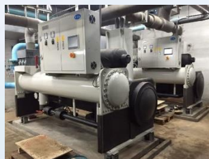
更換冰水主機
