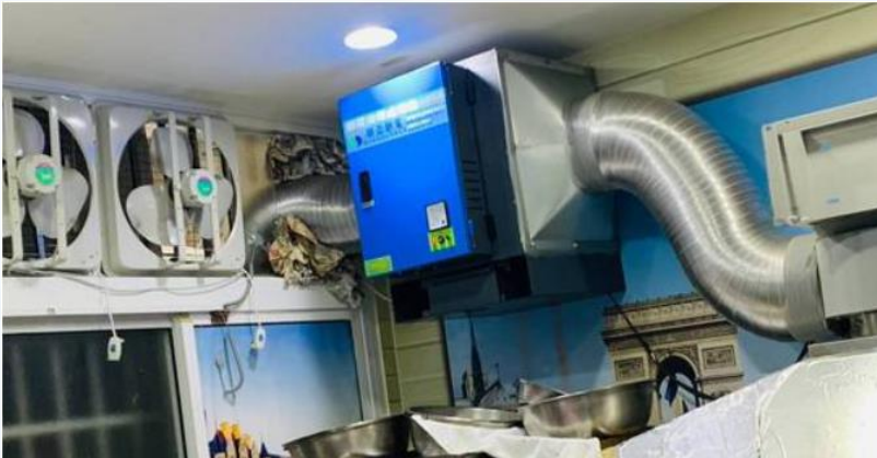
餐廳設置油煙防制設備
