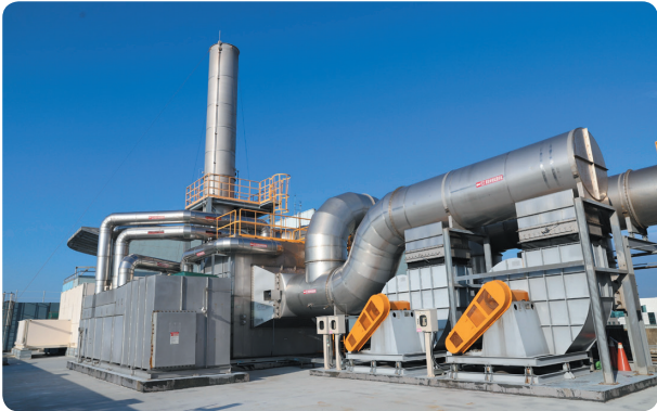
擴充空污防制設備 - 沸石轉輪焚化系統
