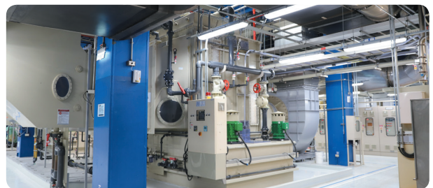
優化空污防制設備 - 廢氣洗滌塔
