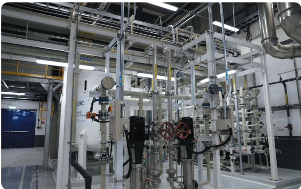
擴充廢氣洗滌塔廢水回收循環系統
